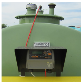
OCIO installato su Tank Fuel
